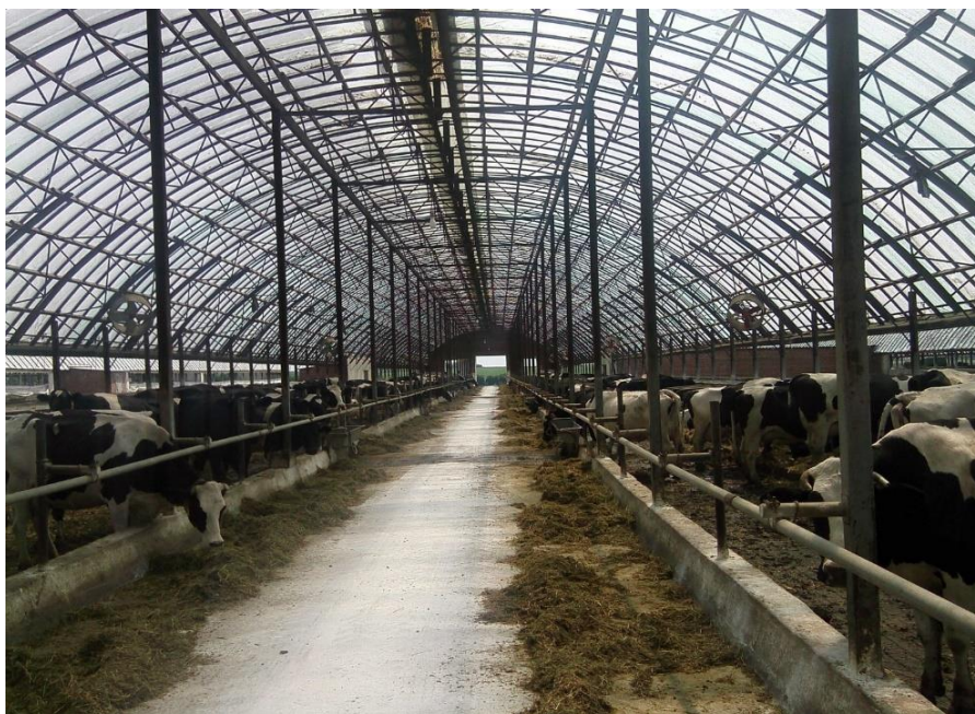
Рис. 1. Каркасно-тентовая животноводческая ферма, покрытие которой выполнено из двухслойной полиэтиленовой пленки
